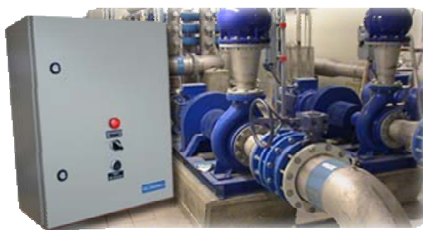
Bilde 5: Overvåkingsanlegg for vannverksinstallasjoner
