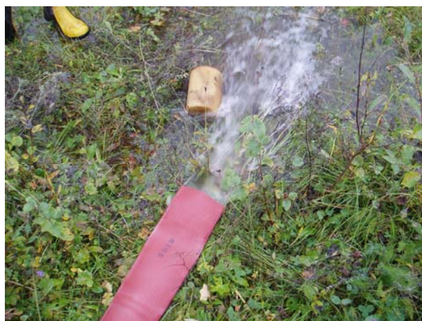
Bilde 3: Utspylt plugg og rent vann i nettet
